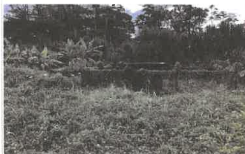
En dicha caseta no se pudo hacer ingreso, debido a la peligrosidad que representa la vegetación, según indicación del Ing. Del MEP no hay tableros, ni servicio sanitario.
